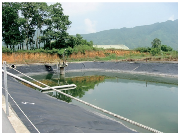
Xử lý nước thải tại Nhà máy sản xuất tinh bột sắn Intimex, Nghệ An
